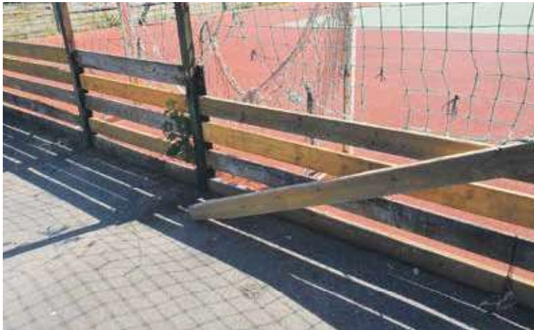
POŠKOZENÉ ČÁSTI sportovišť je nutné opravovat.
